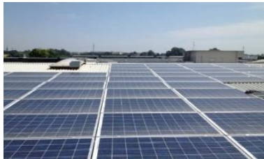
PIEMONTE - 5 MW (Rooftop) - REC
